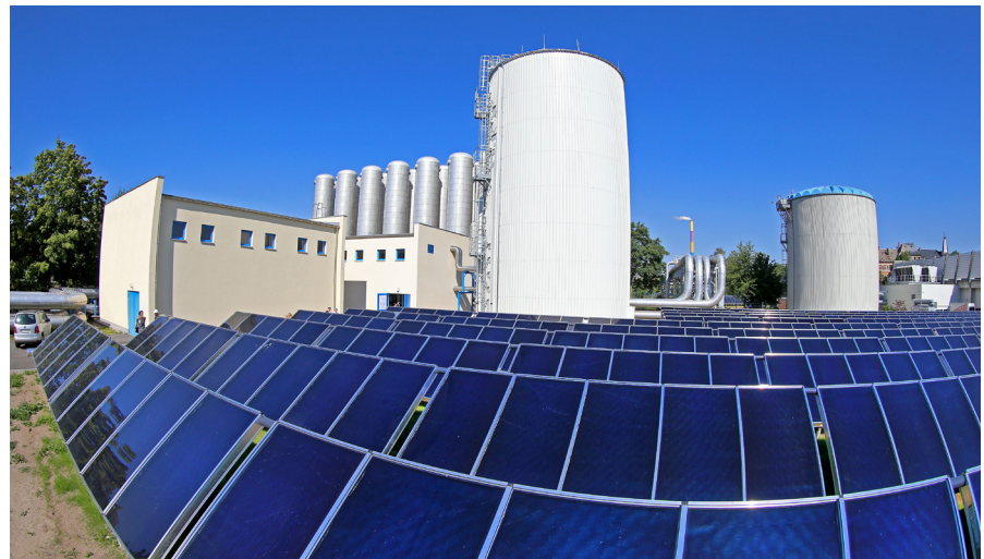
Bild 6 Solarthermische Großanlage in Chemnitz/Brühl
